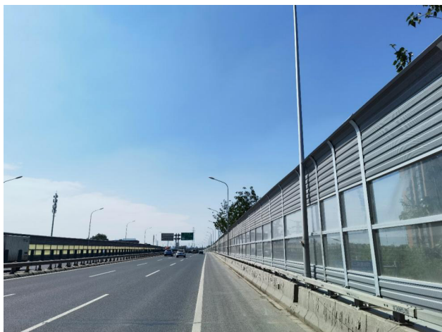
图2 公司承建的机场二通道福润四季声屏障
